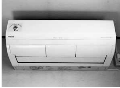
▲羽根山自治会 エアコン3台
